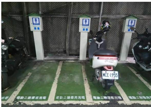
立體機車場機車充電站
