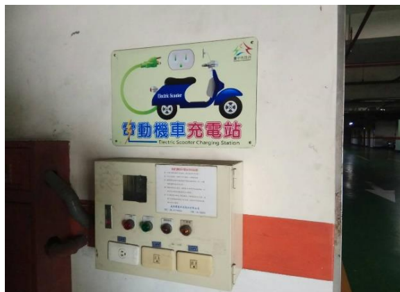
行政大樓機車充電站
